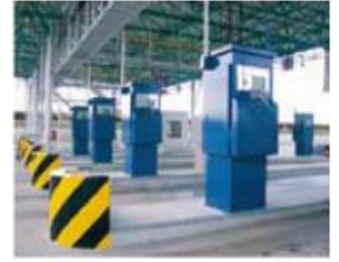
ICCTのクラークレスゲート
